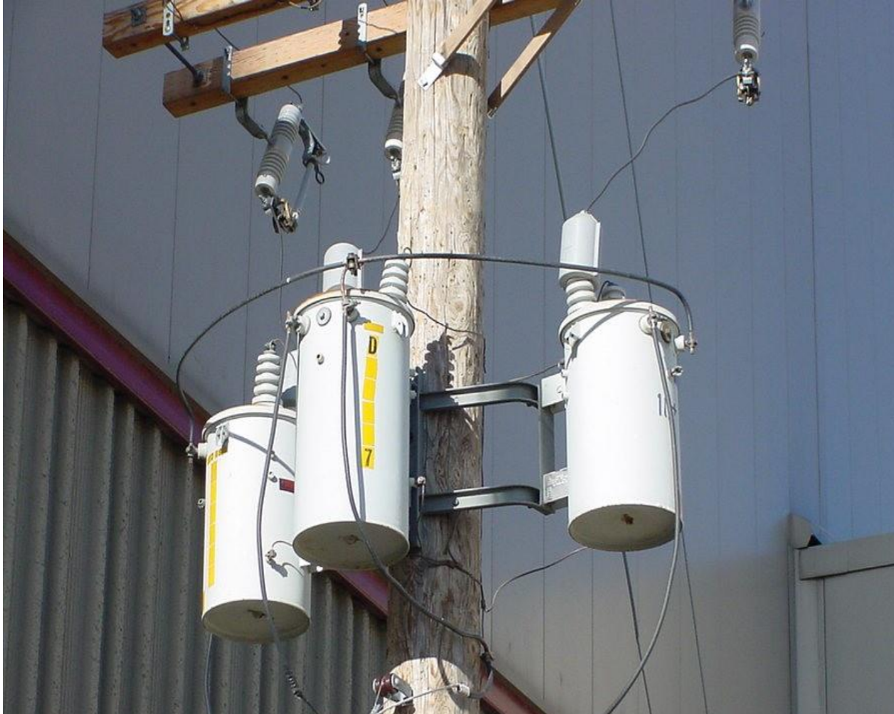
Transformadores de Distribución
