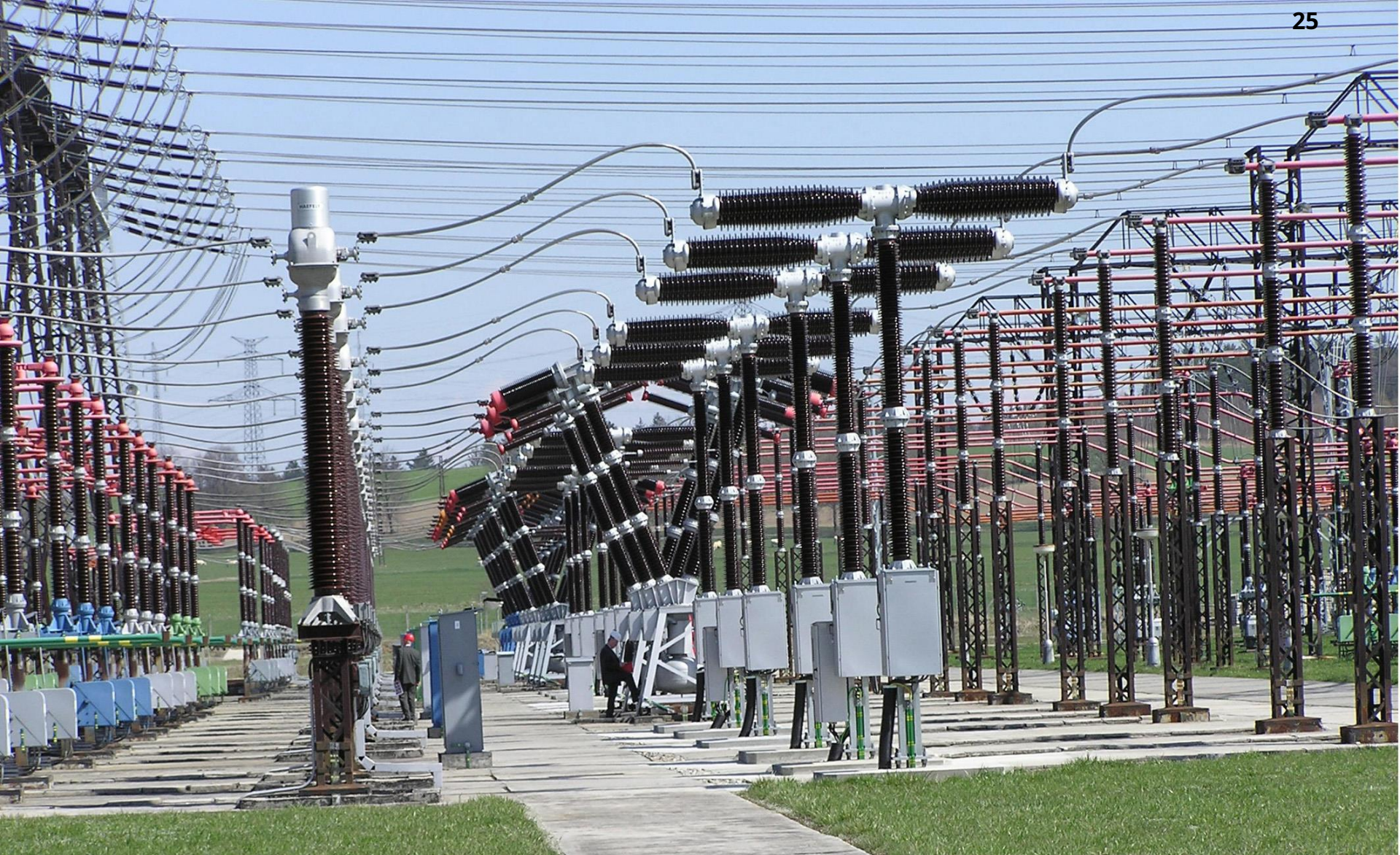
SF 6 Disyuntor lleno de gas
