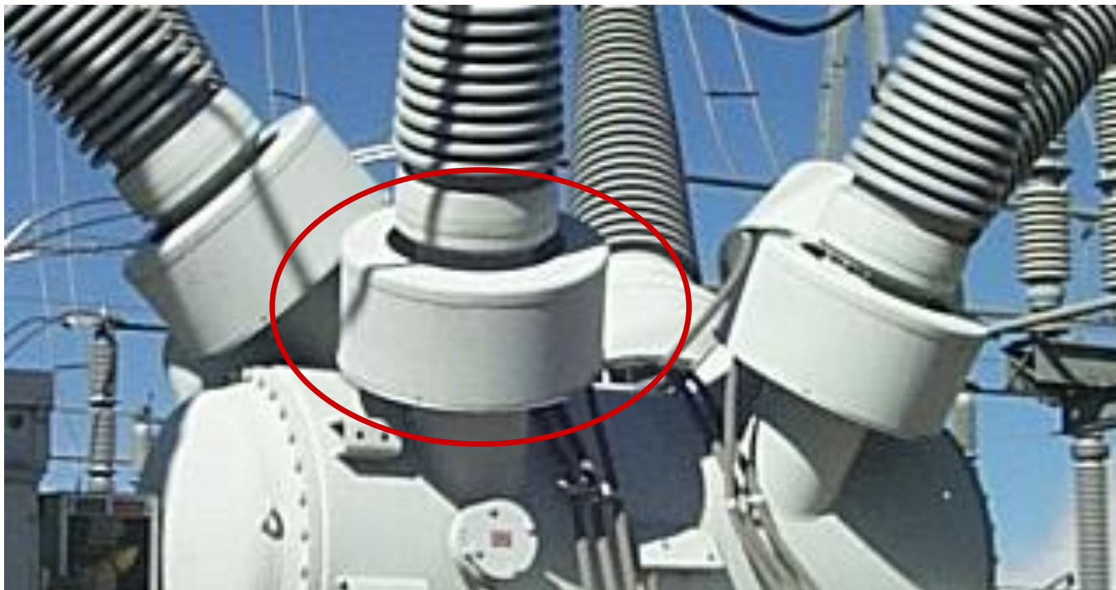
Transformador de medición de corriente (CT)
