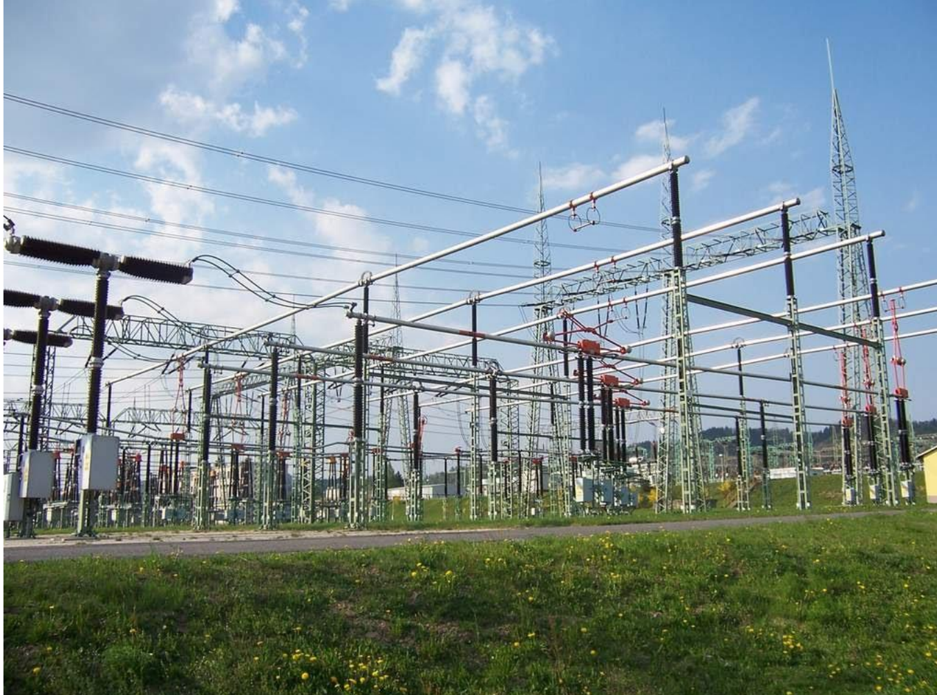
Estación de conmutación
